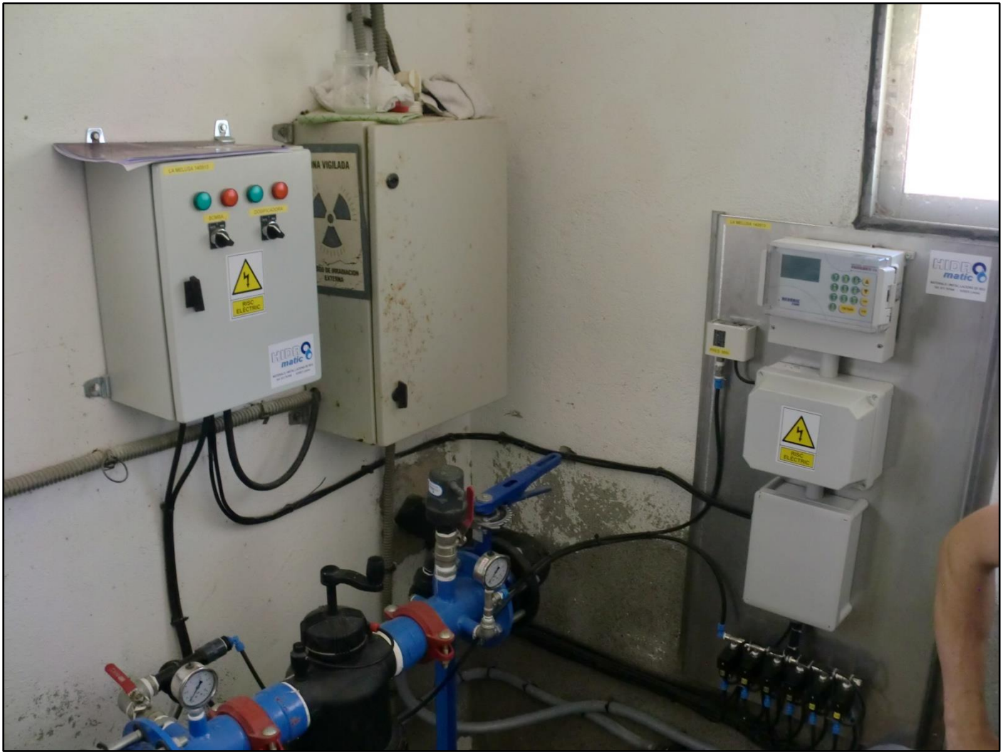
Figura 16. Interior de la estación de bombeo construida.
